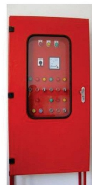
Tủ điện chống cháy
